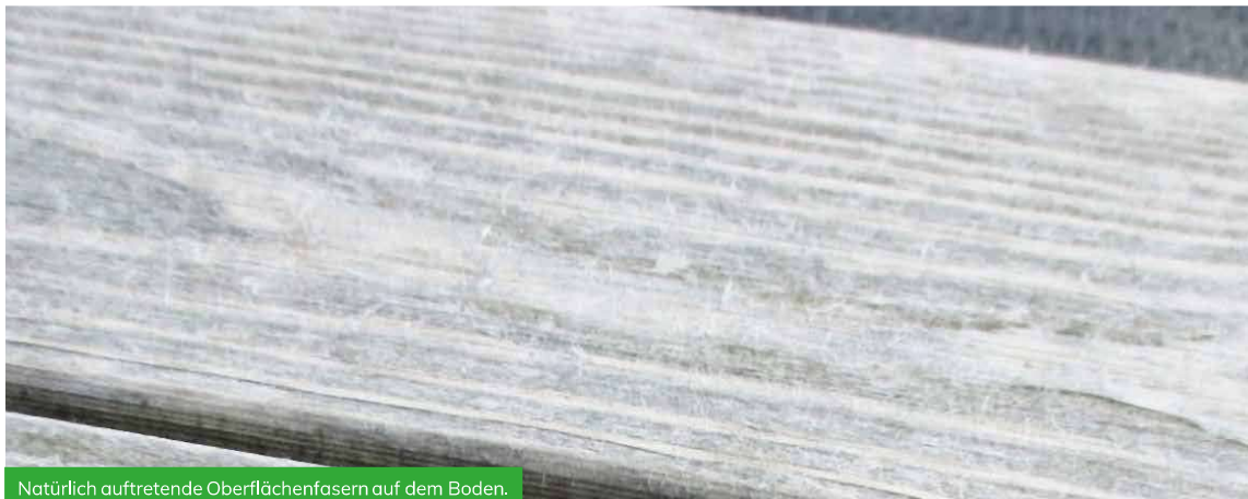
Natürlich auftretende Oberflächenfasern auf dem Boden.
